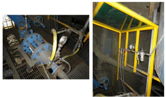
Figura 4 Instalación del cavitador en la alimentación a la columna de cobre Mina Cozamin
